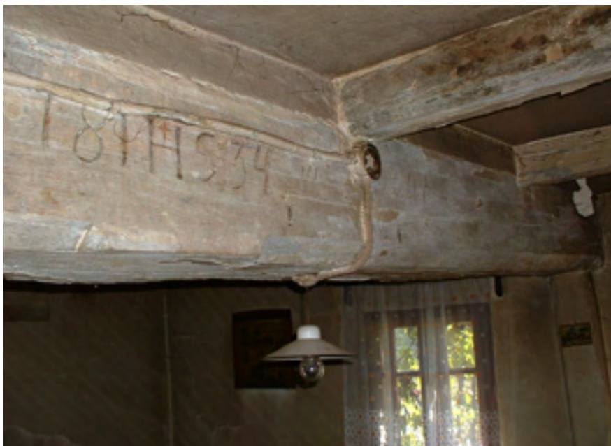
Razvod elektroinstalacije u tradicijskoj kući izveden vidljivim „Bergman” cijevima s žaruljom ispod limenog tanjurastog „širma”
