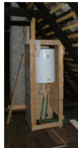
Zbog malog raspoloživog prostora u kupaonici bojler za toplu vodu može se smjestiti u toplinski izoliranu kabinu na tavanu
