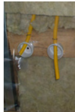
Elektroinstalacija vođena u sloju toplinske izolacije
